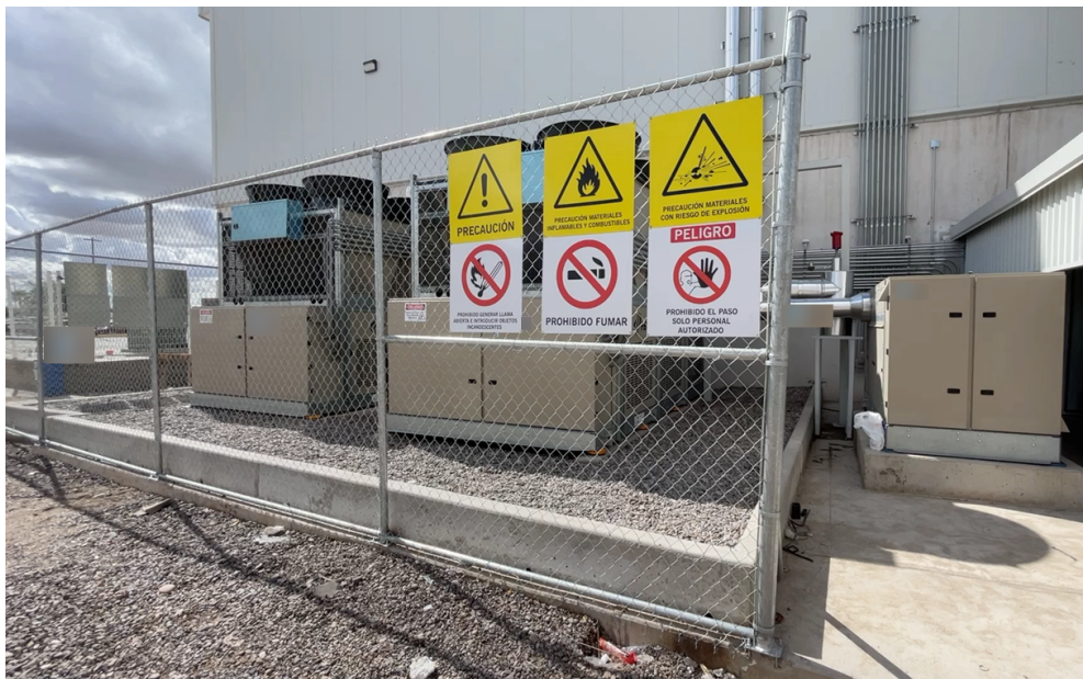
Figura 11: Correcta señalización para refrigerante R-290 / Fuente: Gildardo Yañez
